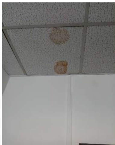
Humidité et infiltrations d'eau
